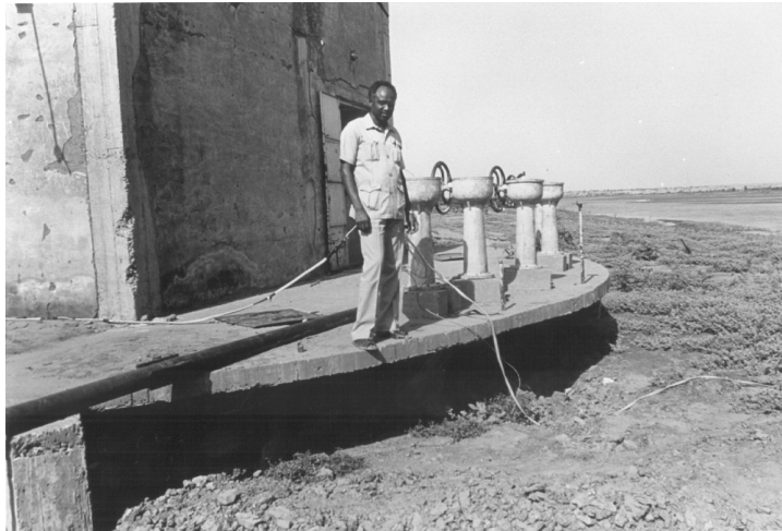
図 1.2 スーダン、アトバラ川にあるカシム・エル・ギルバダム上流デルタ部で堆砂により埋没した取水口 (R. Hotchkiss)
